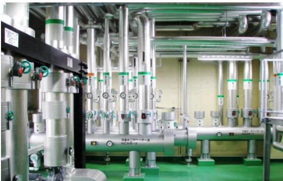
機械室 配管 (パイプ)
